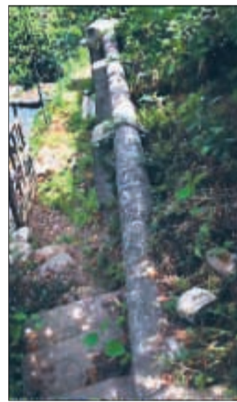
En aval, la canalisation du réseau qui conduit à la station d'épuration.
