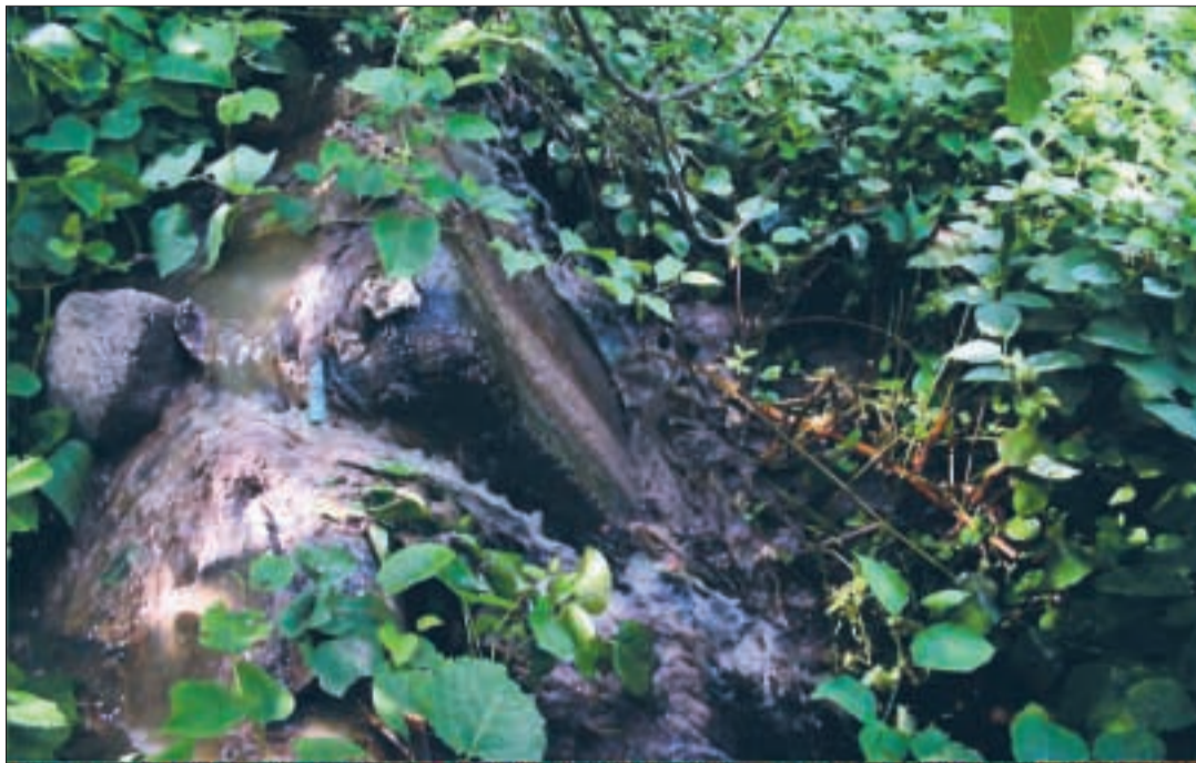
Une fuite dans le réseau d'assainissement provoque un rejet d'eaux usées vers les jardins et le ruisseau en contrebas. Une pollution qui dure depuis plusieurs mois. Photos J. L.
